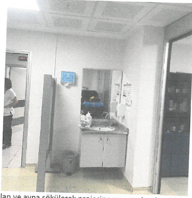
Mevcut lavabo, dolap ve ayna sökülerek projesine uygun olacak şekilde yenisi yapılacaktır.
